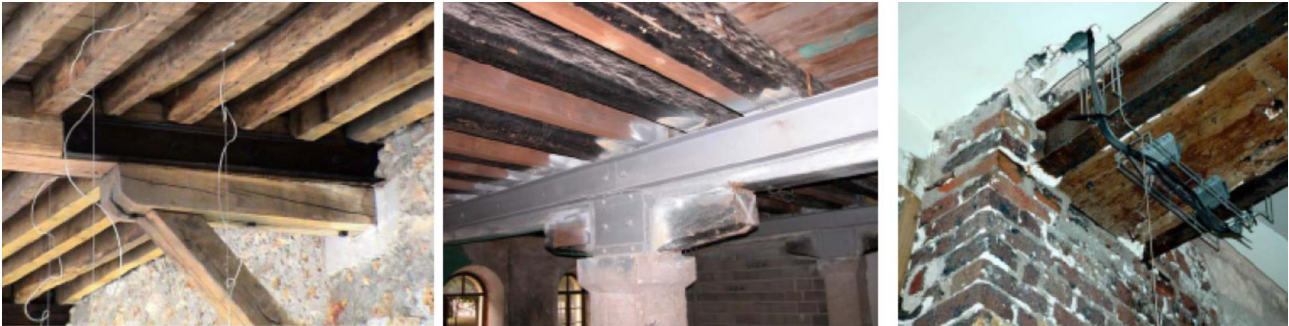
Fig.7 – Esempi di rinforzo di travi in legno in appoggio con profili laminati
